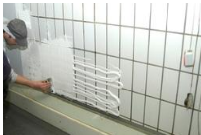
Her utbedres flisbelagte vegger!
